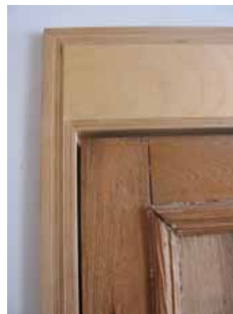
Une porte décapée au jet de sable intégrée à un nouveau cadre. Crédit: E. Cosgrove
