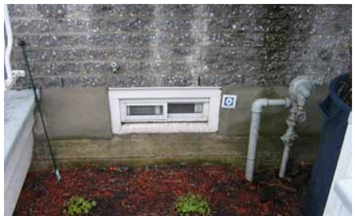
Imposte installé dans un mur de fondation, servant à aérer le vide sanitaire. Crédit: A. Derghazarian.
