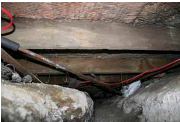
Vide sanitaire d'une maison centenaire à Montréal. Le plancher est en terre et les services d'électricité et de plomberie le traversent. On y aperçoit également les solives du plancher de rez-de-chaussée. Crédit: A. Derghazarian
