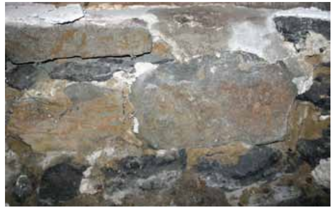
Les traces blanches sur ce mur de fondation trahissent un problème d'infiltration d'eau. Crédit: A. Derghazarian
